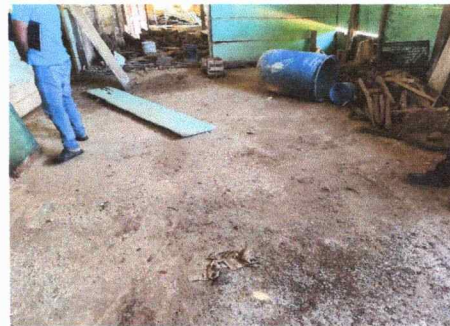
Foto 4: Se observa el deterioro y mal estado del piso
