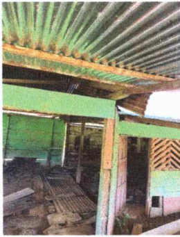
Foto 3: Se observa el deterioro de las columnas del corredor
